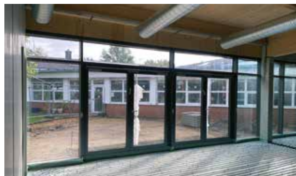
Hell und warm dank Fußbodenheizung und Spezialglas
