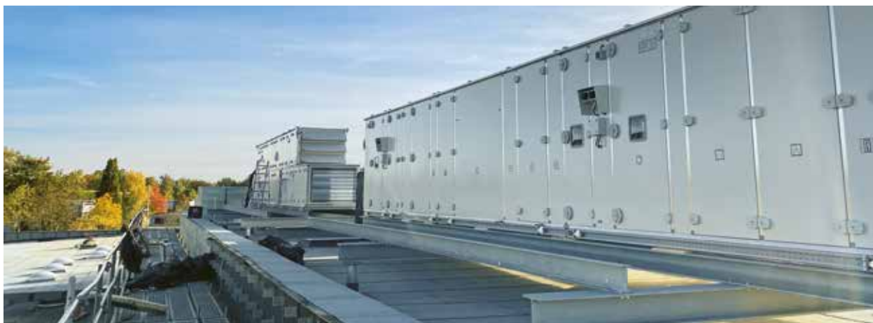
Lüftungsanlage in luftiger Höhe
